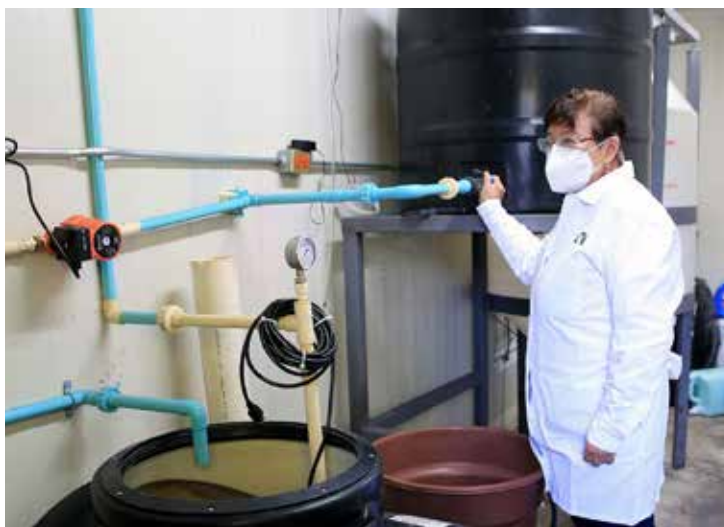
Filtro para remover metales de la red de agua potable de la Alcaldía Iztapalapa
