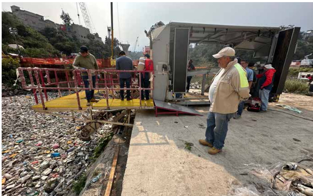
El Sistema Acuático “Todo en Uno” es transportable, modular y recolecta residuos en cuerpos de agua
