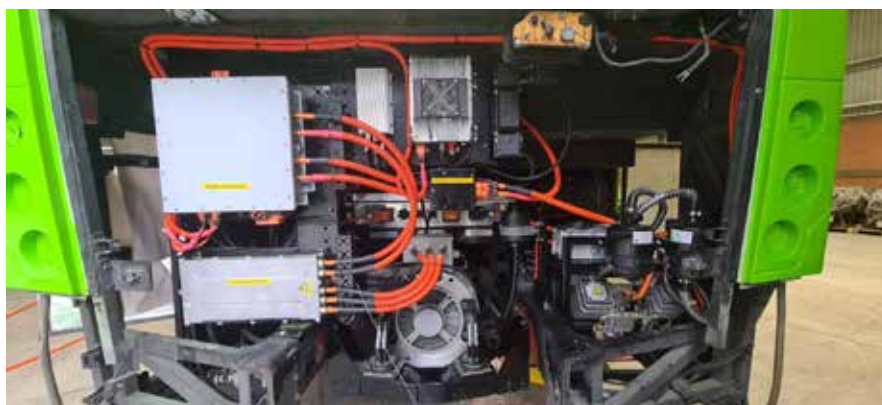
Paquete de baterías de litio con capacidad y voltaje suficiente para reintegrar al autobús a una ruta
