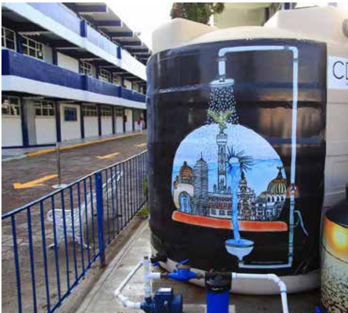
Sistema de captación de agua de lluvia en escuelas de nivel básico
