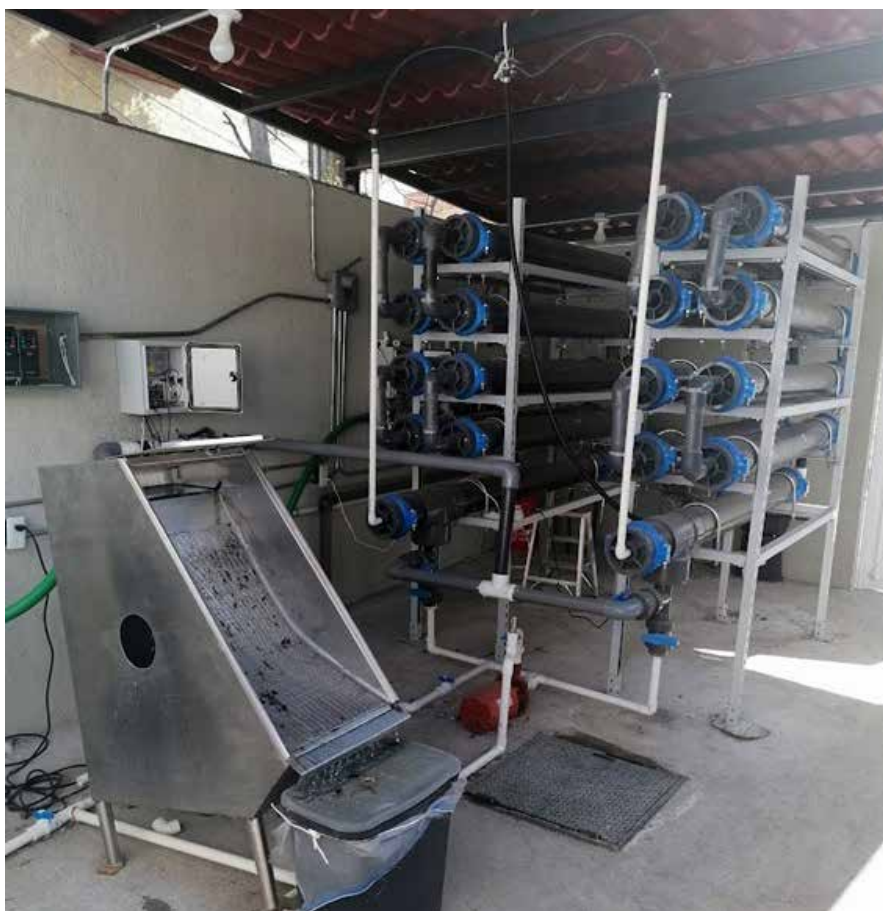
Tratamiento de aguas mediante procesos biológicos y electroquímicos, en módulos tubulares compactos y de bajo costo
