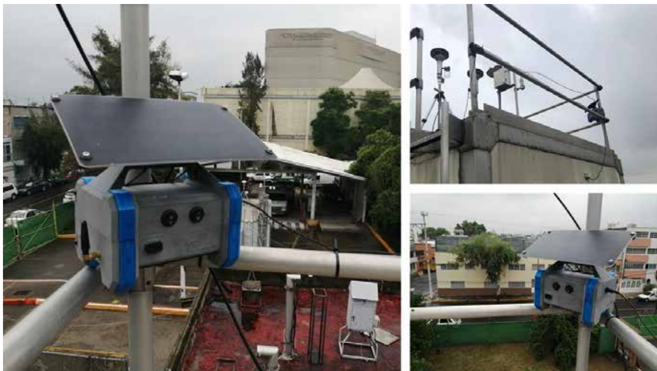
La energía del dispositivo es suministrada a través de un eliminador de corriente directa o mediante una celda de energía solar
